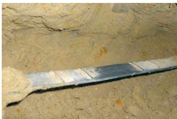
Photo 7 : observation d'une armature depuis l'ouverture réalisée en parement – Source : Jean-Marc Jailloux
