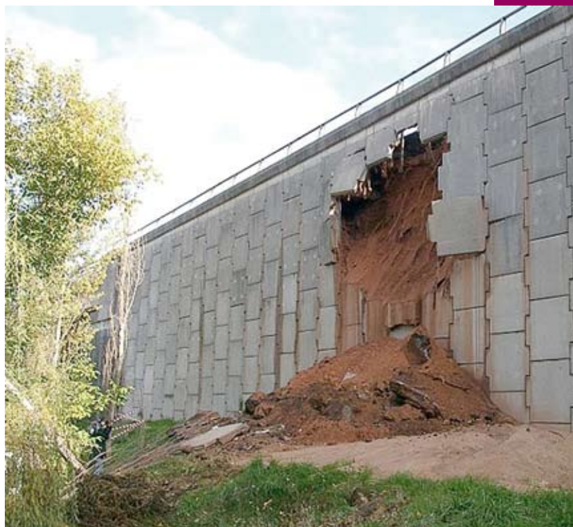
Photo 1 : effondrement local d'un mur de soutènement en terre armée construit en 1974 Source : LR de Strasbourg
